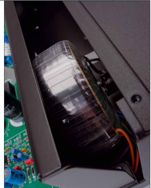
Sauber abgeschirmt sitzt der Ringkern-Netztrafo in seinem eigenen Abteil. Er stellt sechs verschiedene Spannungen zur Verfügung
